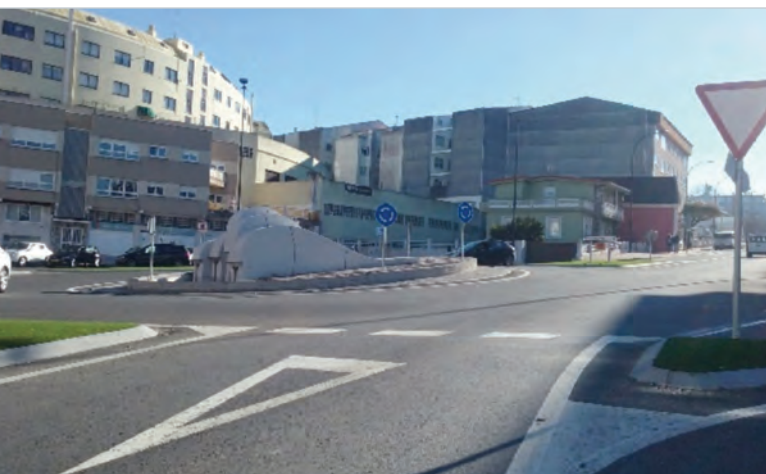
Fotografía 3.- Pendiente mal ejecutada en glorietas.
